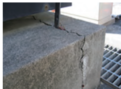
看板基礎のひび割れ
