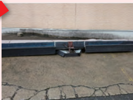
落下した欄間看板
